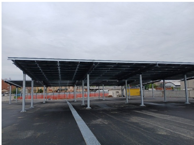
parcheggio dotato di pensiline fotovoltaiche
